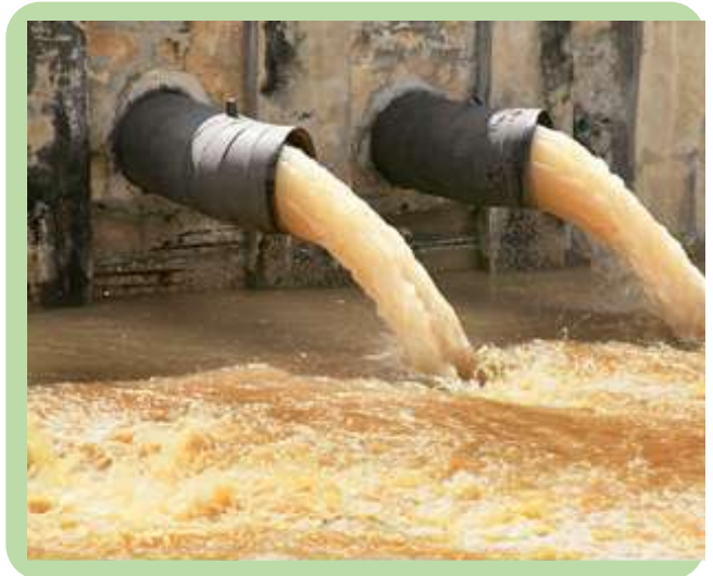
Tratamiento de aguas residuales
